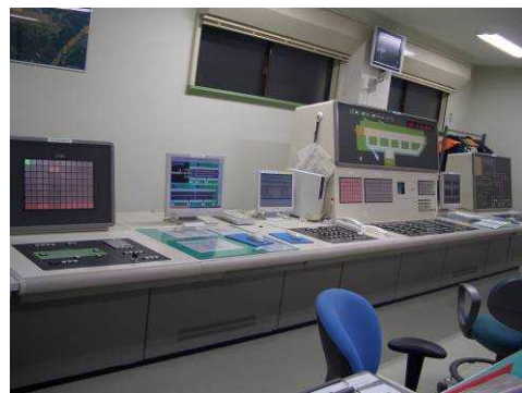
電源局舎の監視制御室
