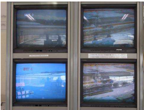
監視カメラ画像(管理事務所3階)
